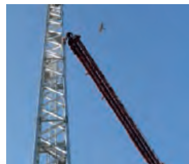
Situation inadmissible : la flèche peut toucher le mât de l'autre grue.
