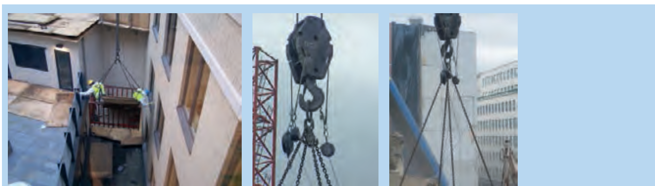
Les langes de la protection individuelle contre les chutes sont coincées dans l'élingue à quatre brins à laquelle la nacelle est suspendue. Il ne s'agit pas d'une solution sûre.
